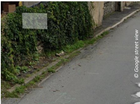
Interruption du trottoir entre la rue des deux frères et l'allée des jardins.
