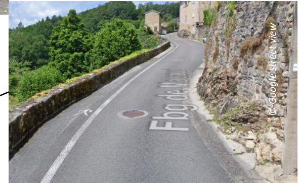
Cheminement piéton dégradé; besoin d'affirmer la séparation ou le partage voirie.
