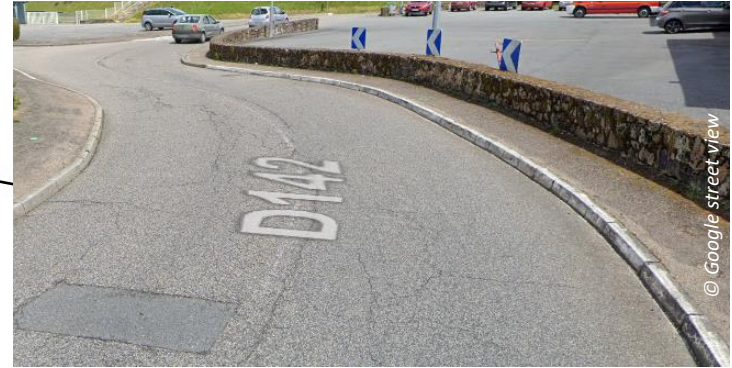
Rupture cheminement (végétation qui déborde)
