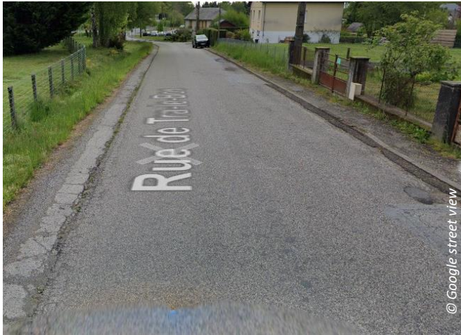
Accès dégradé à l'IUT
